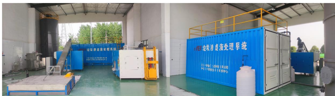
图 5.2.4 好氧生化处理 D 项目处理流程和实景
